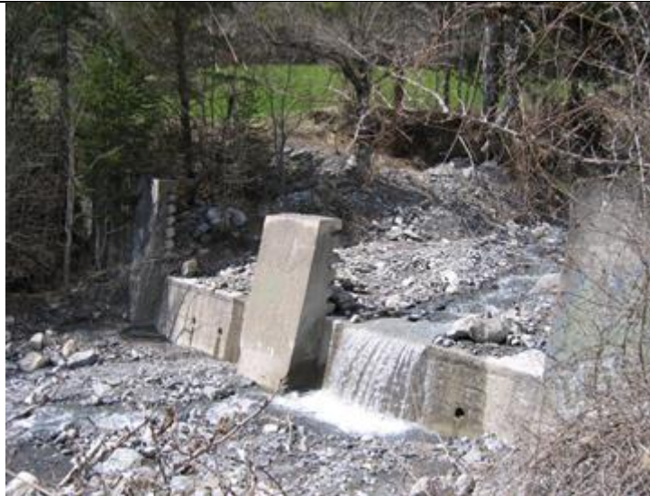
B4 – dent central, ancien ouvrage avec barres métalliques -2006
