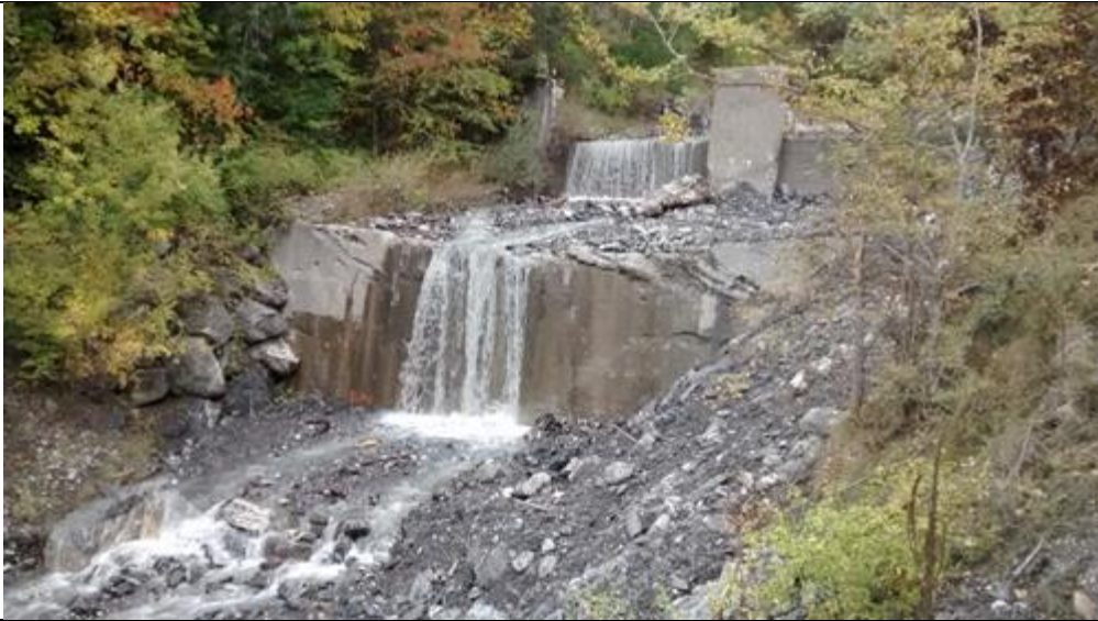
B3 – léger affouillement en pied– septembre 2015
