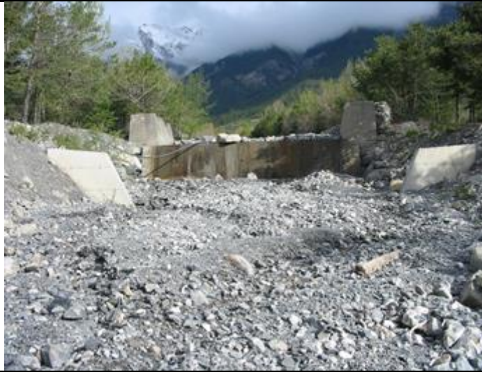
TB2a – ouvrage pratiquement totalement enseveli - 2006
