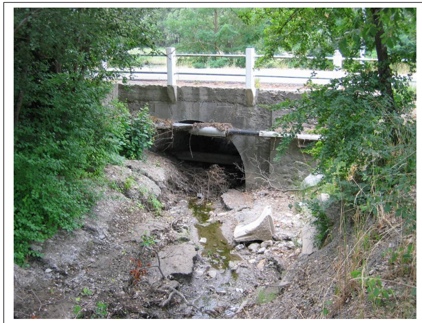
Ouvrage de franchissement de la RD951 par le ravin du DEFFEND MARTIN.
