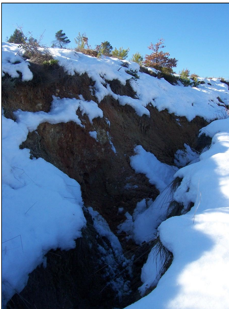
Figure 6: Chemin raviné (surcreusement des fossés de 0,5 m à 0,80 m) et glissement superficiel favorisé par l'érosion du talus.
