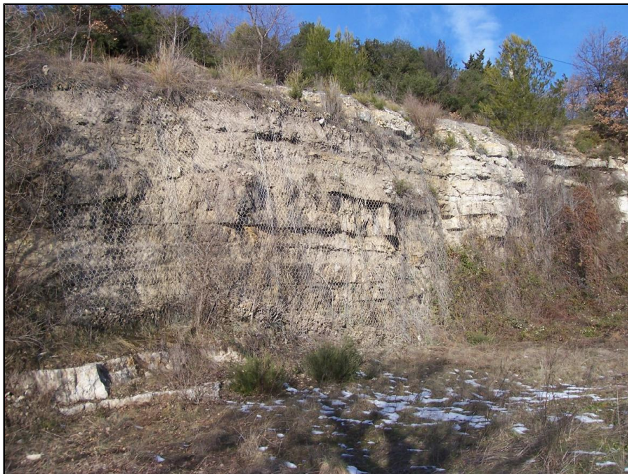
Figure 9: Barre rocheuse avec grillage plaqué de protection contre les chutes de pierres.
