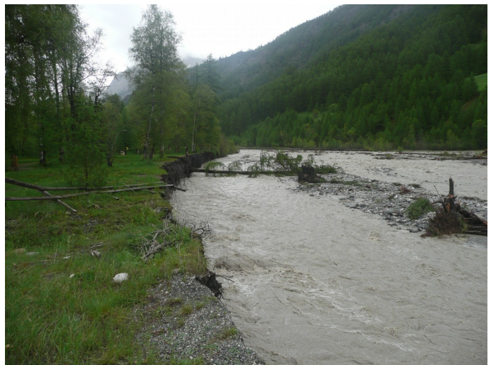
Illustration 2: Érosion de berge au niveau du camping de Saint-Paul-sur-Ubaye lors de la crue de 2008
